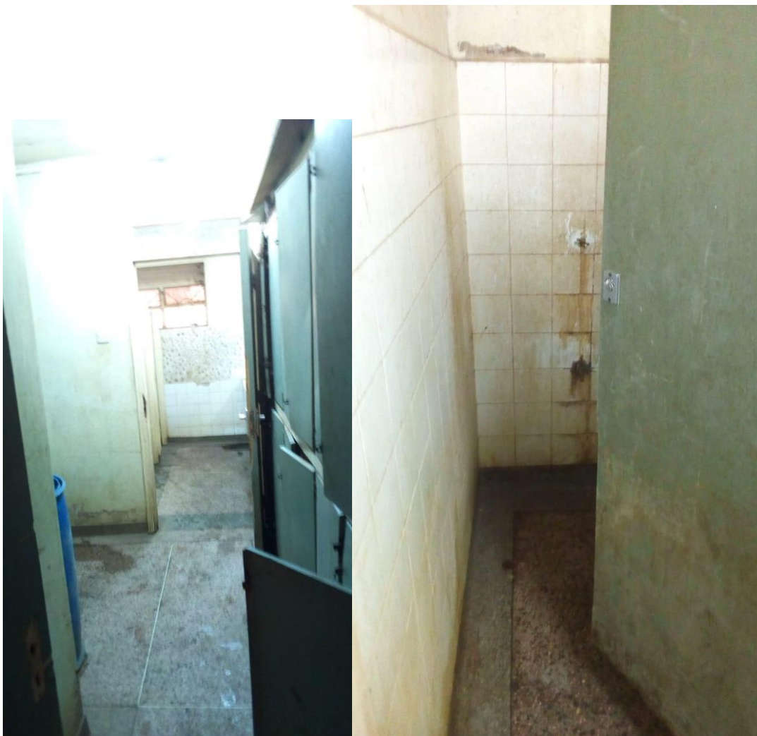
Foto: toilette in stato fatiscente, sporche e maleodoranti del centro PCEA
